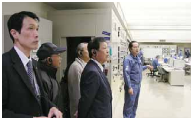
発電所の頭脳である中央操作室に入りました
